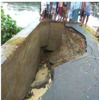
6. m) Collapsed road
